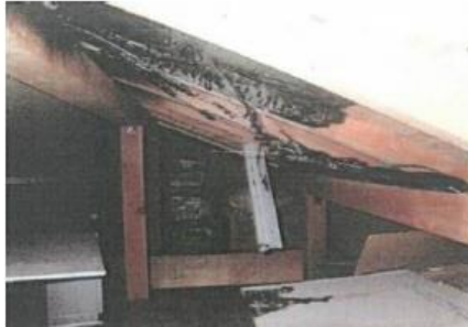
写真 2-7 住宅に設置された太陽光発電設備の火災事例
