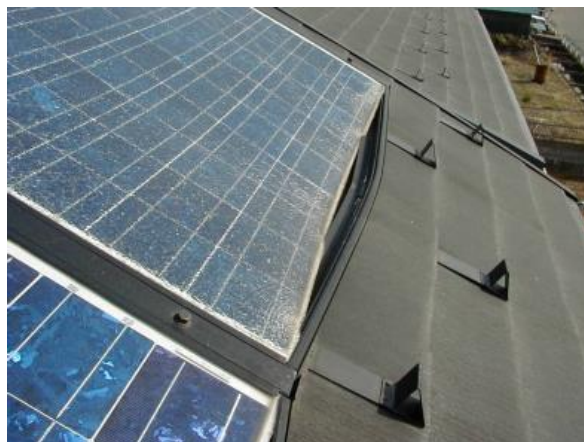
写真 2-3 住宅に設置された太陽光発電設備の地震被害事例 (出典：有限会社吉富電気提供)
