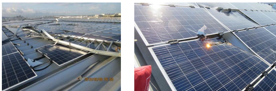
写真 2-2 折板屋根に設置された太陽光発電設備の強風被害事例
