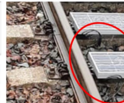
分離型のパネルの配線
