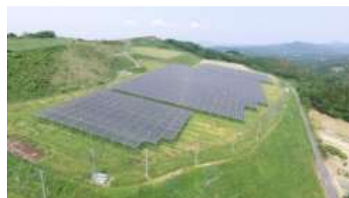
発電設備の外観（吉高地区）
