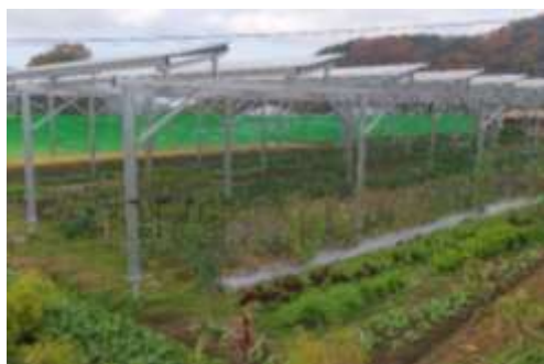
発電設備の外観
