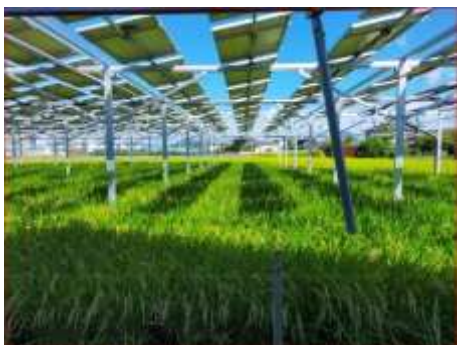
地区①の発電設備の外観
