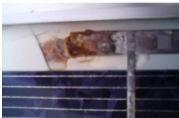
図 4-1 はんだ接続部の変色の例
