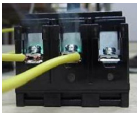
図 3.4-1 AC ブレーカ利用による事故例
