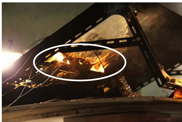
図 12 モジュール裏面の自己燃焼 (円内の白色が炎)
